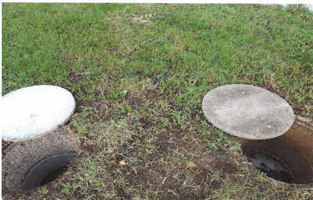
Fosse toutes eaux avec début de corrosion
